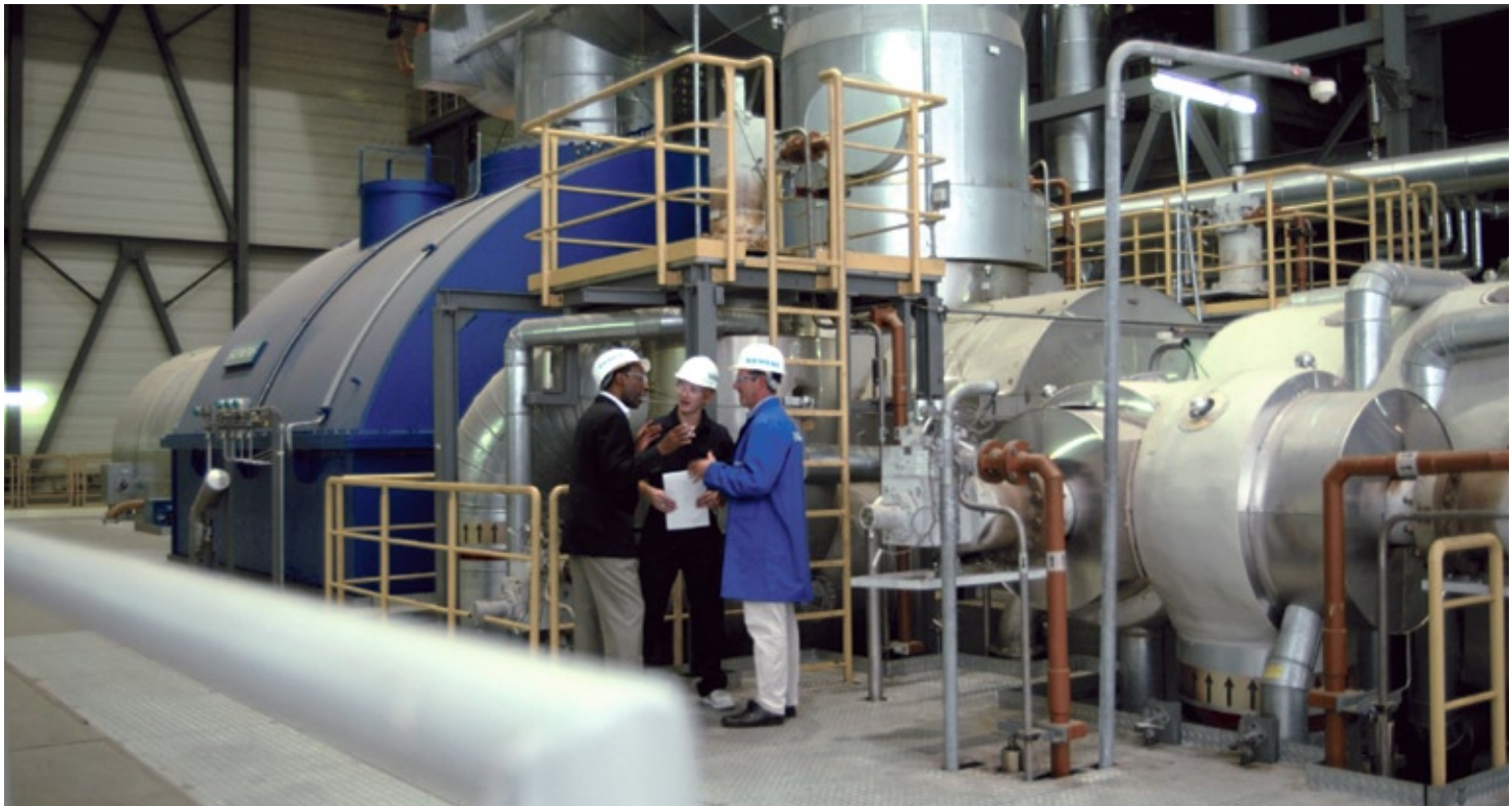
Abb. 13: Dampfturbine im GuD-Kraftwerk
