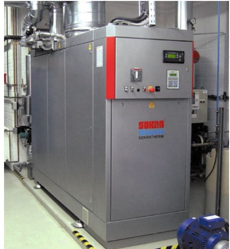
Abb. 26: BHKW „SOKRATHERM GG 140“ der Fa. SOKRATHERM GmbH & Co. KG
