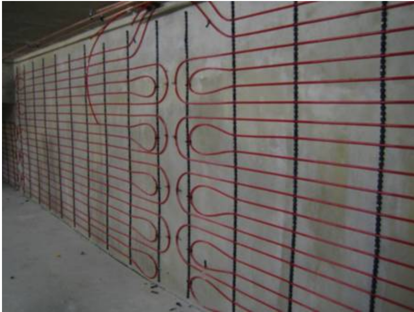
Wandtemperierung im Bestandskeller aus Abwärme der Sommerkühlung
