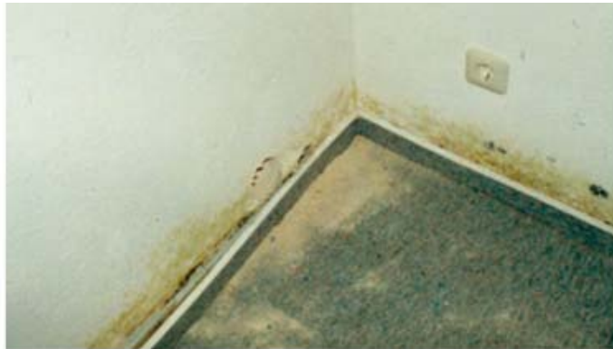
Feuchteschäden im Sockelbereich durch Kondensatbildung
