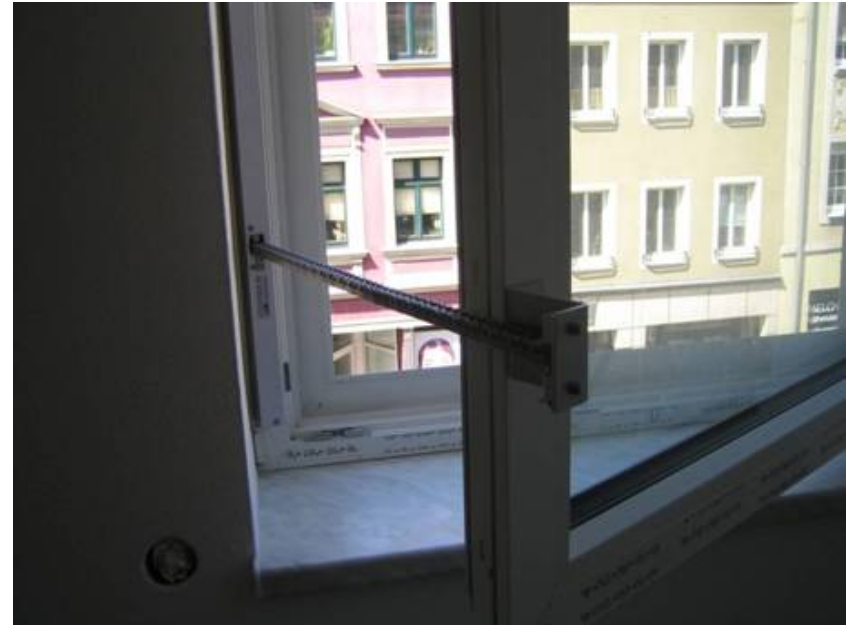
automatischer Rauchabzug in Passivhaus-Qualität
